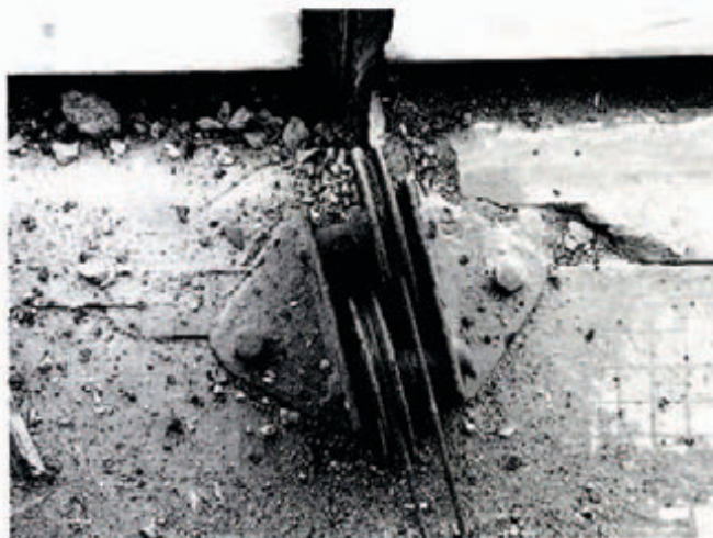
Ico Centrale: dettaglio della facciata di via Jervis e una delle carrucole del sistema di apertura manuale delle finestre prima del restauro.
